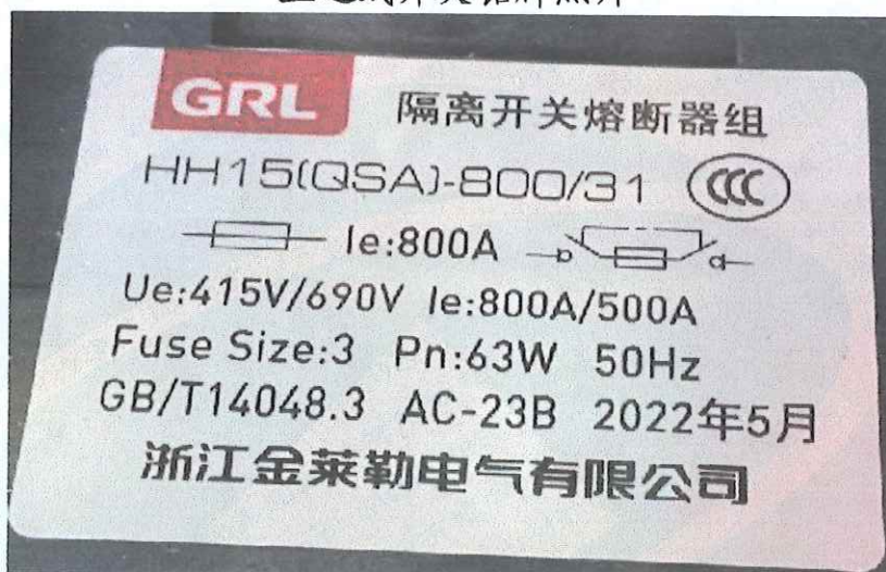
主进线开关铭牌照片
