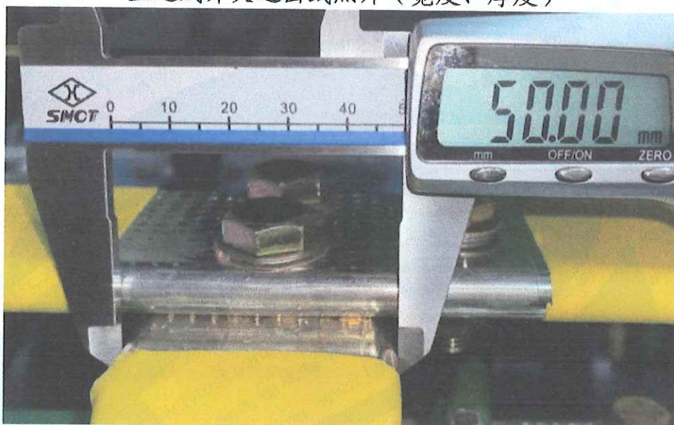
主进线开关进出线照片（宽度、厚度）
