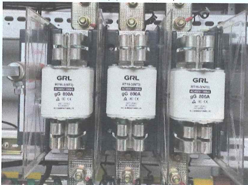
主进线开关正面照片
