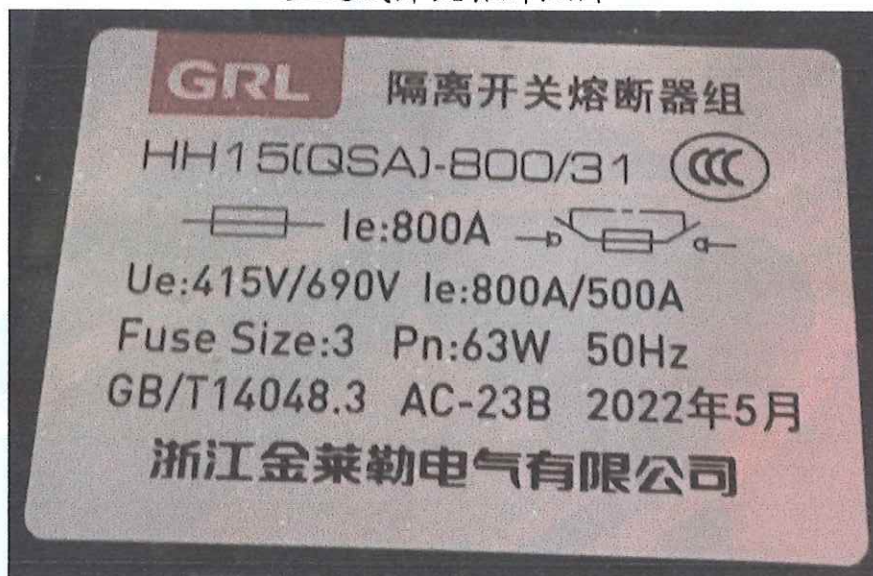
主进线开关铭牌照片
