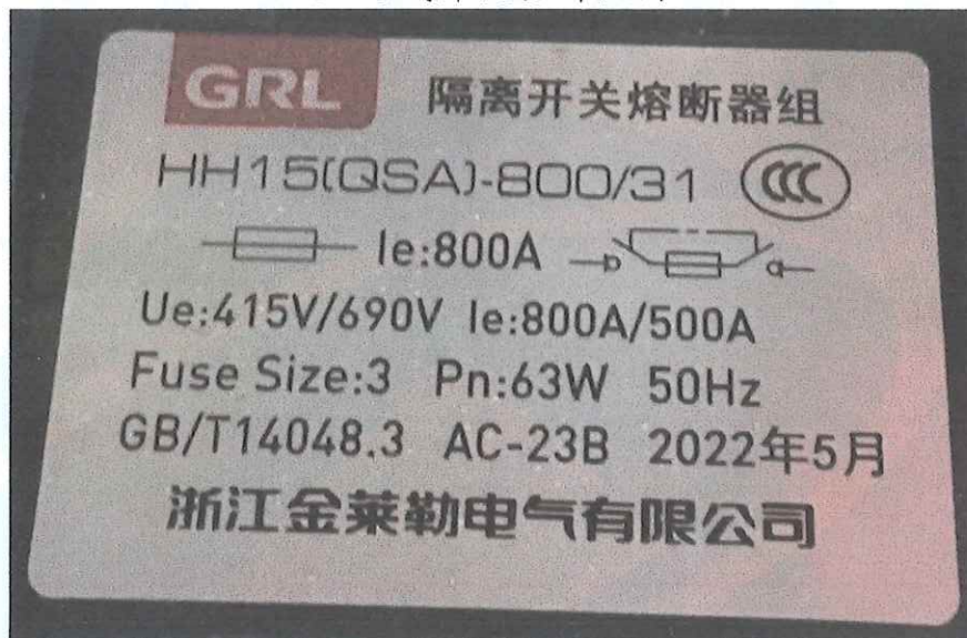
主进线开关铭牌照片
