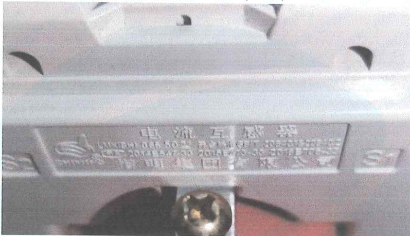
电流互感器铭牌照片
