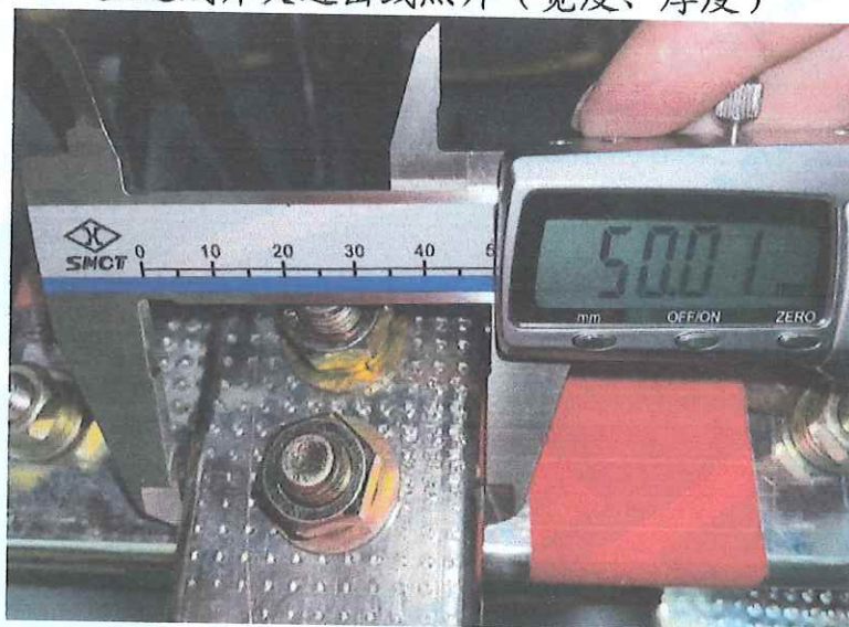
主进线开关进出线照片（宽度、厚度）
