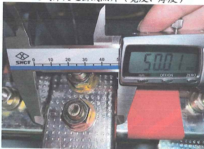
主进线开关进出线照片（宽度、厚度）
