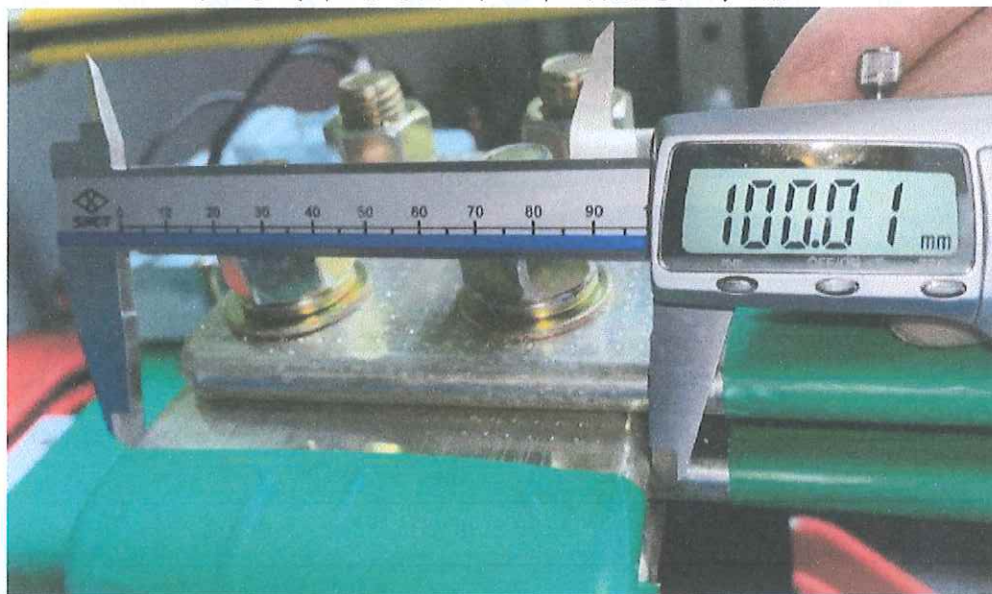
主进线开关进出线照片（宽度、厚度）
