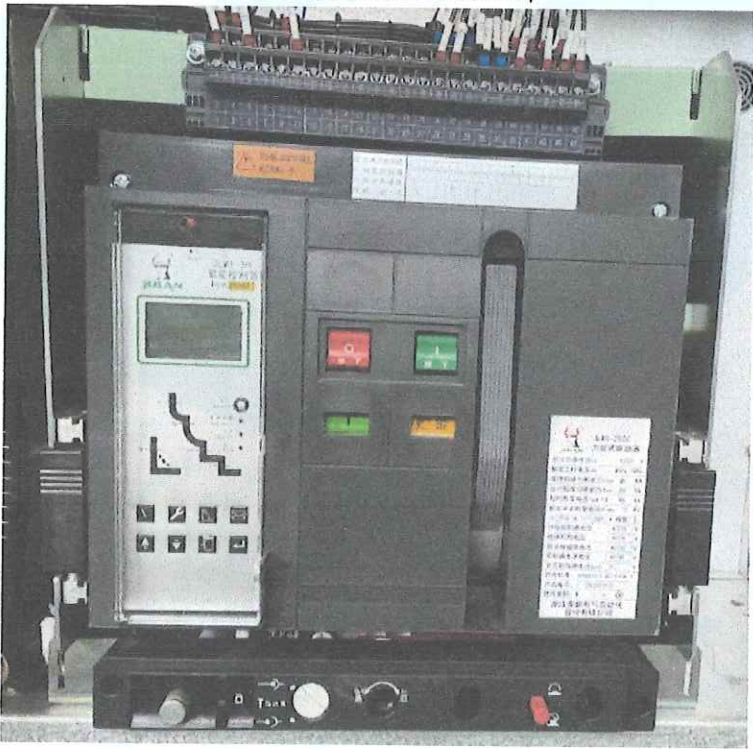
主进线开关正面照片
