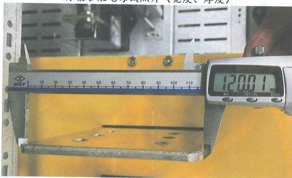
方案5 配电母线照片（宽度、厚度）
