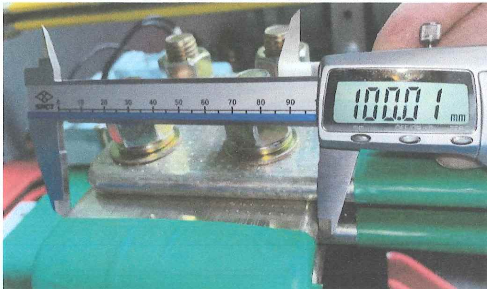
主进线开关进出线照片（宽度、厚度）
