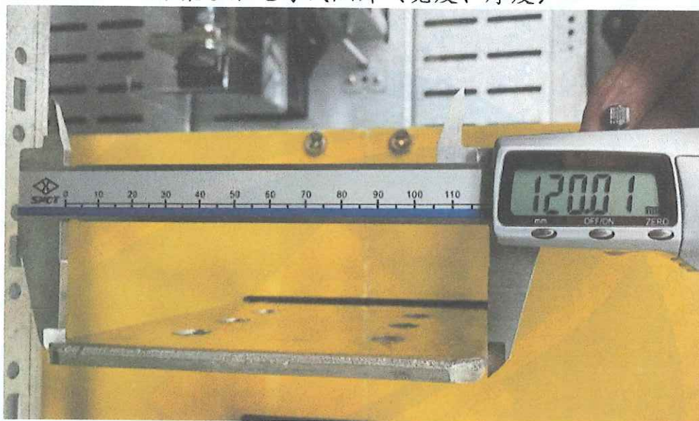
方案 5 配电母线照片（宽度、厚度）
