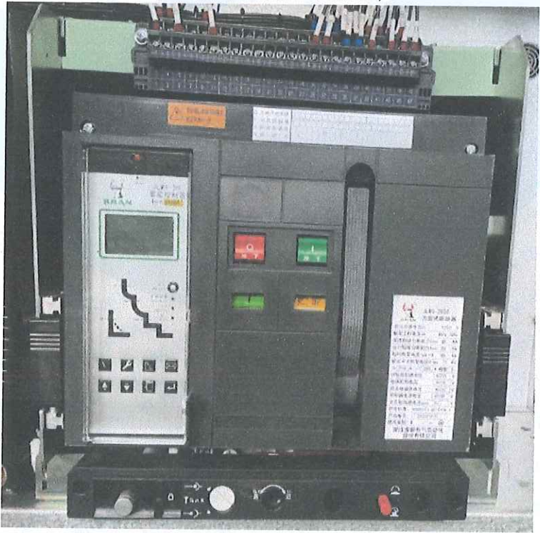
主进线开关正面照片
