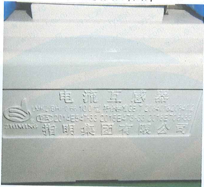
电流互感器铭牌照片
