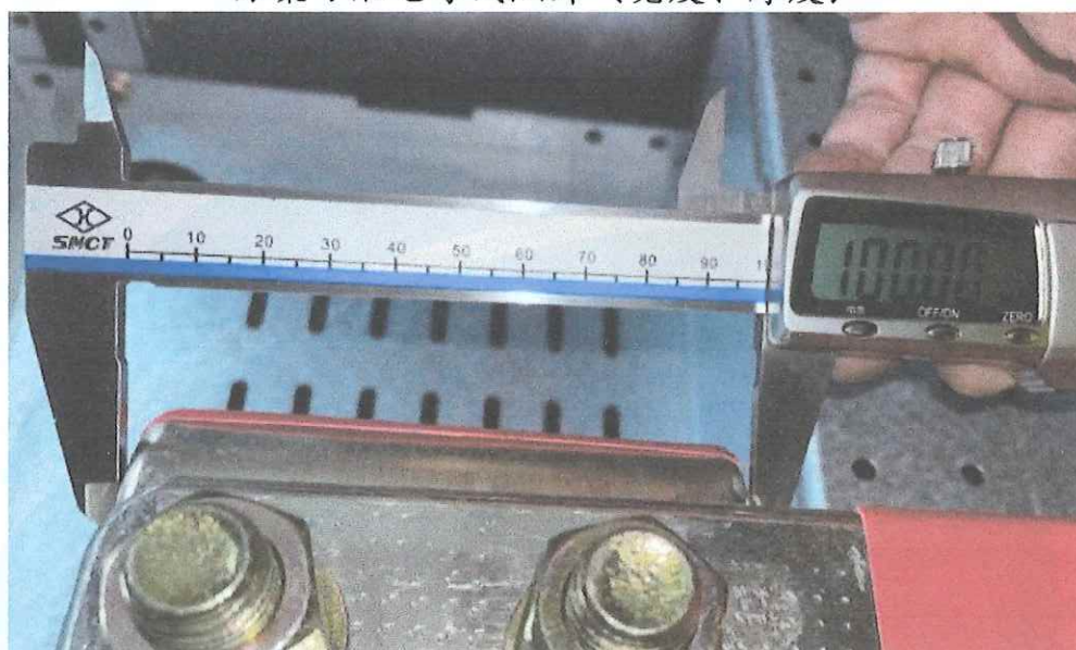
方案 4 配电母线照片（宽度、厚度）
