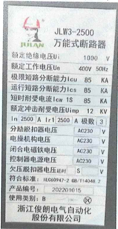
主进线开关铭牌照片
