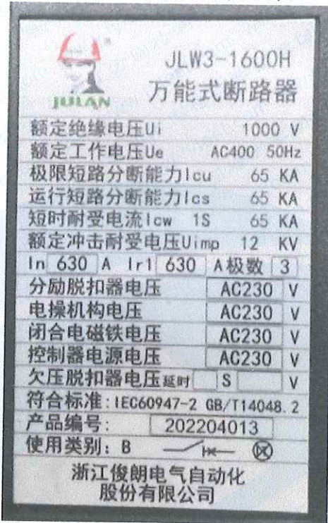
方案 4 开关铭牌照片
