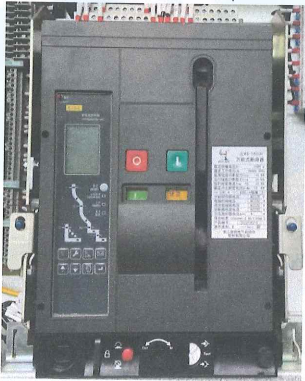
方案 4 开关正面照片
