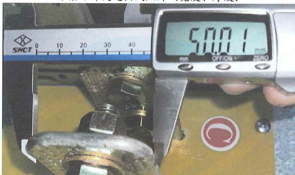
方案 4 开关进出线照片（宽度、厚度）
