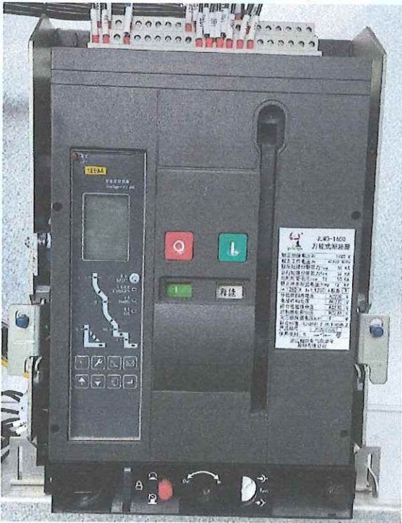
主进线开关正面照片
