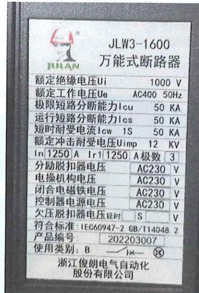
主进线开关铭牌照片
