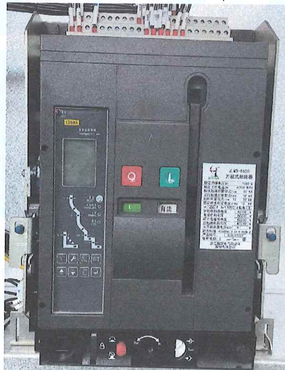
主进线开关正面照片
