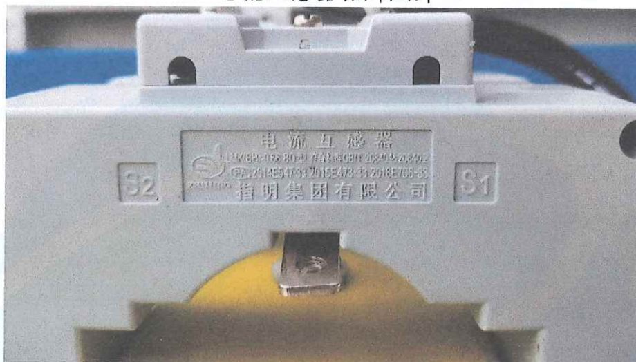
电流互感器铭牌照片
