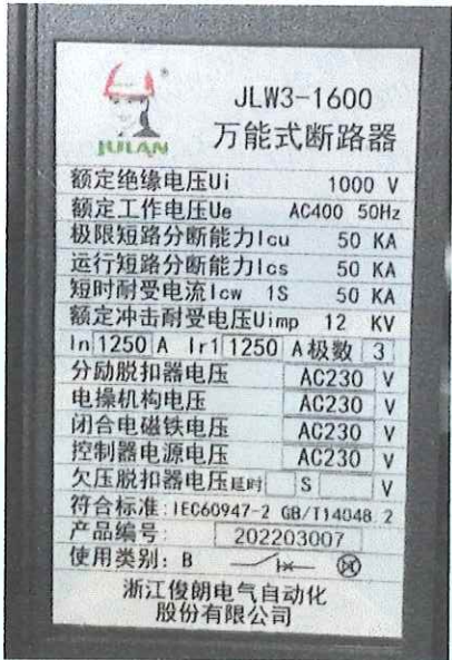
主进线开关铭牌照片
