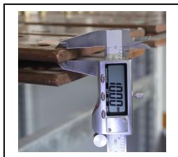
主开关进出母线
