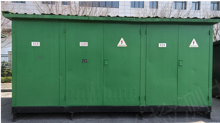
样品正面照片
